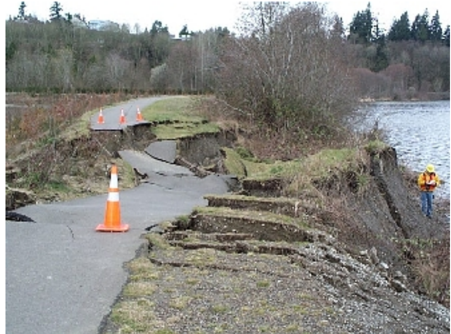
Camino afectado por lateral spread, terremoto de Seattle, 2001
